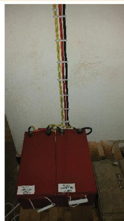
batterie de 220ah
