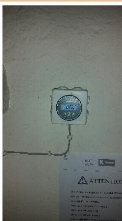
Moniteur des batteries en fonctionnement & vue de l'état de charge des batteries
